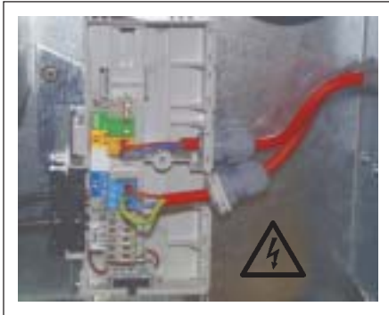
Bild: Klemmkasten: Gefahr durch elektrische Spannung
