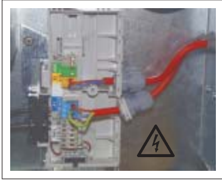
Figura: Caja de bornes: Peligro por tensión eléctrica
