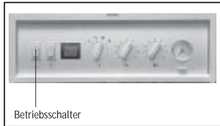
Bild: Gesamtansicht Regelung
