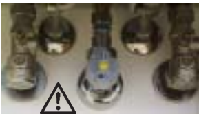
Bild: Gasanschluß: Gefahr von Vergiftung und Explosionsgefahr durch auströmendes Gas
